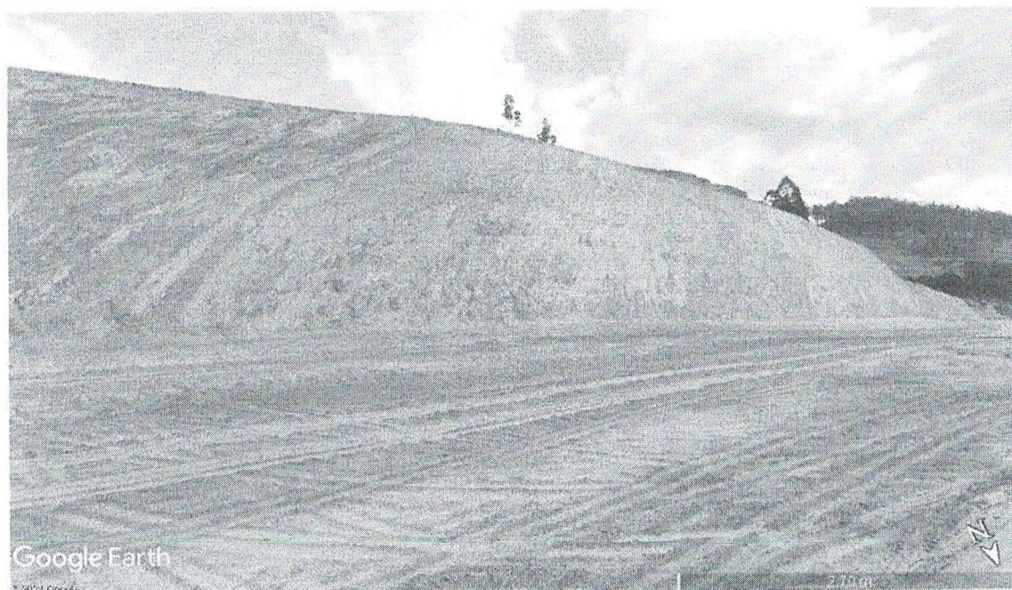
Figura 1 – Talude de corte à margem da BR-482 (Imagem do Google Earth, atualização em agosto/2024).
